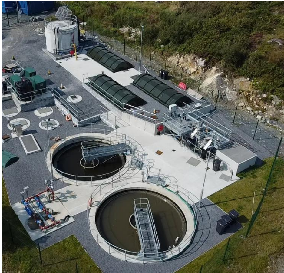
Ionad Cóireála Fuíolluisce an Spidéil
